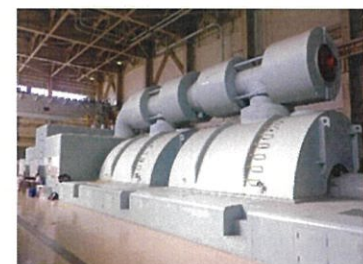
蒸気タービン
